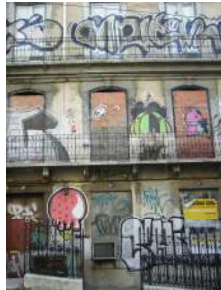
Fig.45 - Edifício degradado na Rua do Alecrim (II)
