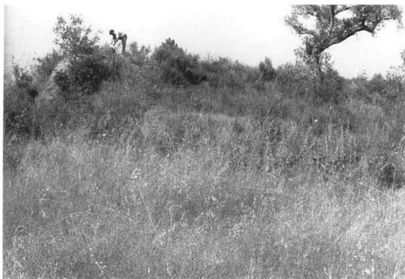
FOTO 3 – Barragem da Orca (Fundão). Vista geral do aterro na margem esquerda, de jusante, notando-se a escarpa da brecha
