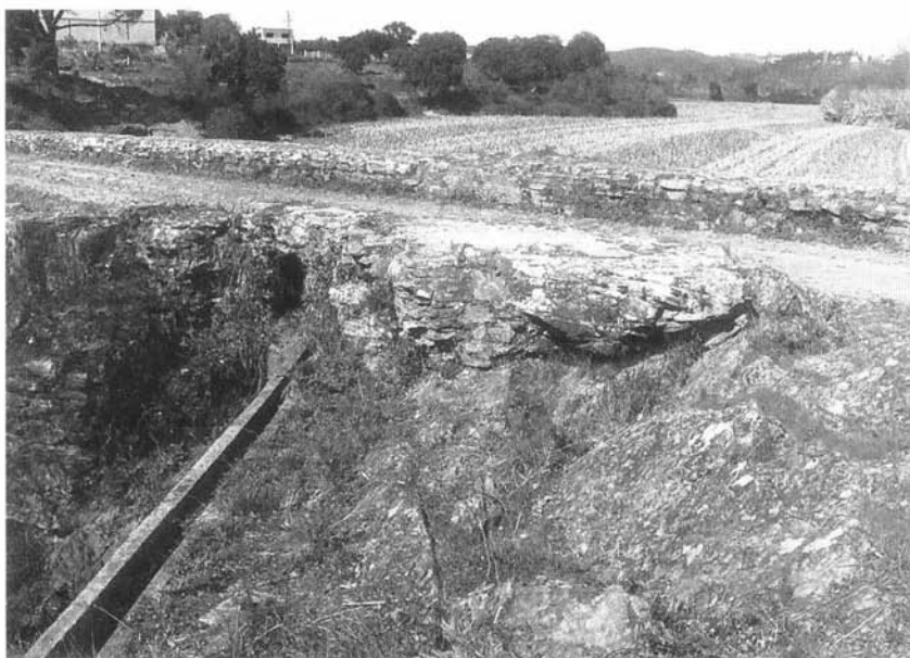
Foto 32 – Barragem de Alferrarede (Abrantes). Vista de jusante, notando-se, em primeiro plano, uma caleira de construção recente e, em último plano, a albufeira assoreada.
