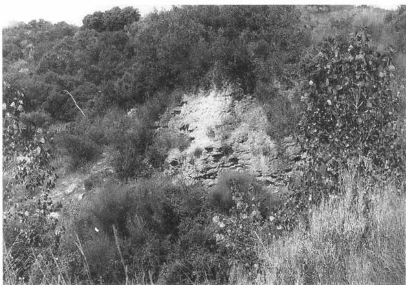
FOTO 15 – Barragem da Egitânia (Idanha-a-Nova). Talude da brecha, da margem direita, observado da margem esquerda
