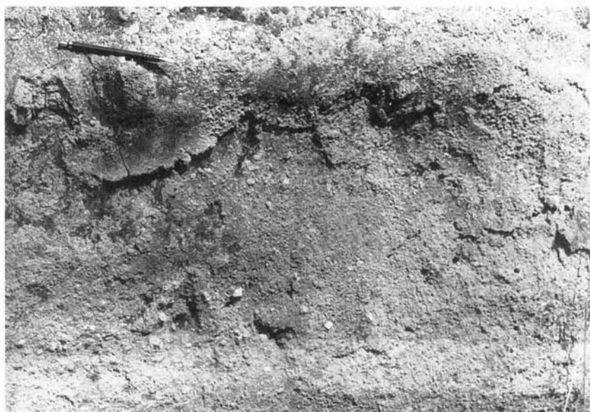
FOTO 5 – Barragem da Orca (Fundão). Vista do pormenor da estrutura do aterro na brecha, evidenciando a execução do aterro por camadas
