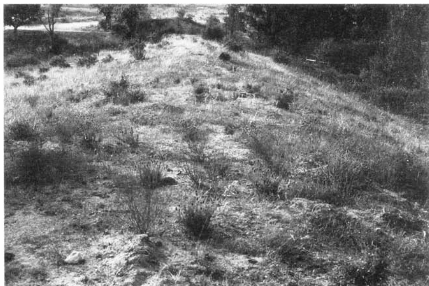
FOTO 22 – Barragem de Monforte (Castelo Branco). Vista geral do aterro obtida para a margem direita
