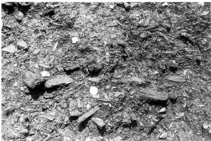
Foto 25 – Barragem da Lameira (Vila Velha de Ródão). Estrutura do aterro, aparente no talude da brecha na margem esquerda, notando-se uma moeda de 31 mm de diâmetro
