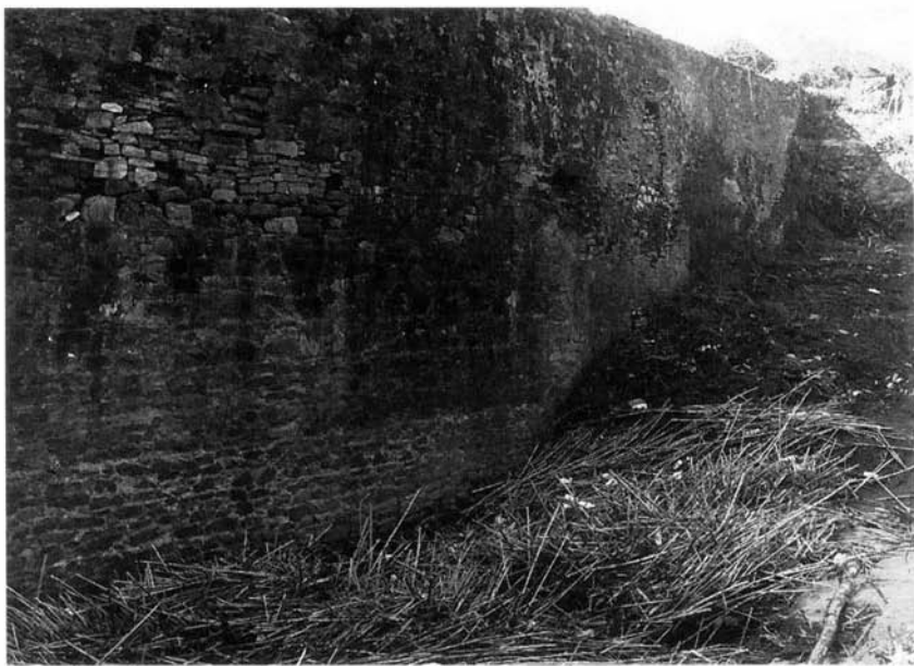
Foto 29 – Barragem de Alferrarede (Abrantes). Vista do paramento de montante, notando-se, próximo do extremo da margem direita, restos de muro de opus signinum da primitiva barragem romana
