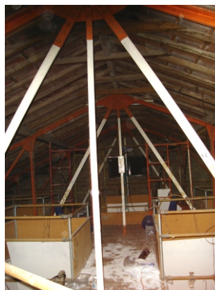
Estrutura metálica da cobertura da antiga adega, reestruturada na década de 1920. 19 Mário Lisboa 2006
