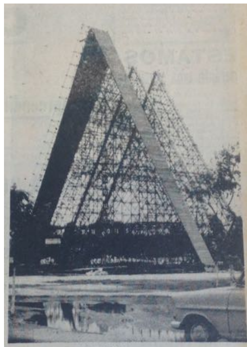
Fig.131 Artigo jornal com a montagem da estrutura de apoio Fonte: Jornal de Angola de 15 de Março de 1968
