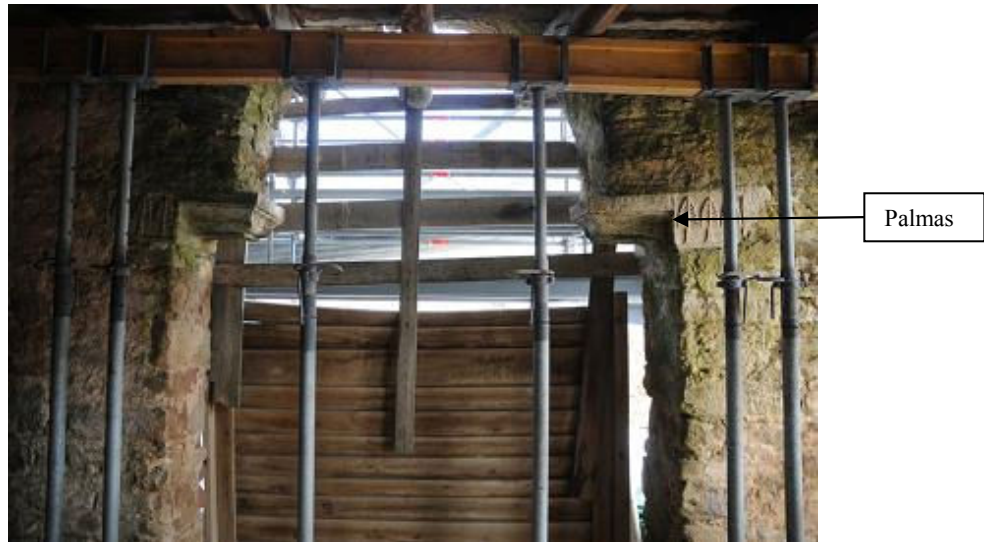
Foto N° 13 – Abertura em arco que deveria dar acesso à Abside. Pode verificar-se que faltam dois apoios (colunas) para sustentação das impostas. Na face interior das impostas encontram-se esculpidas as três palmas. (Foto: Carlos Fidalgo)
