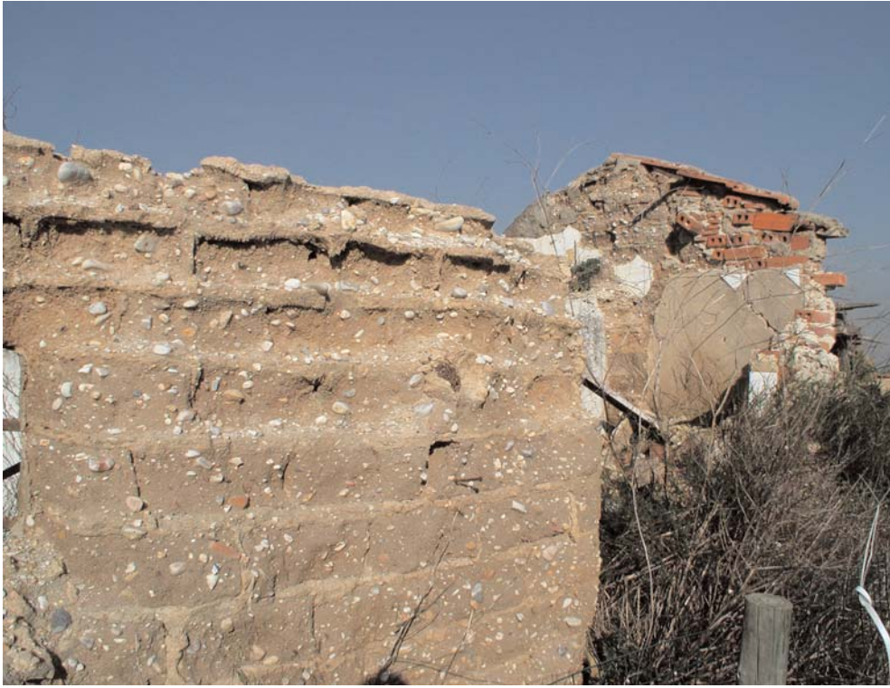
Foto 13 - Parede em adobe no lugar da Regateira, Charneca de Caparica, Francisco Silva, 2008.
