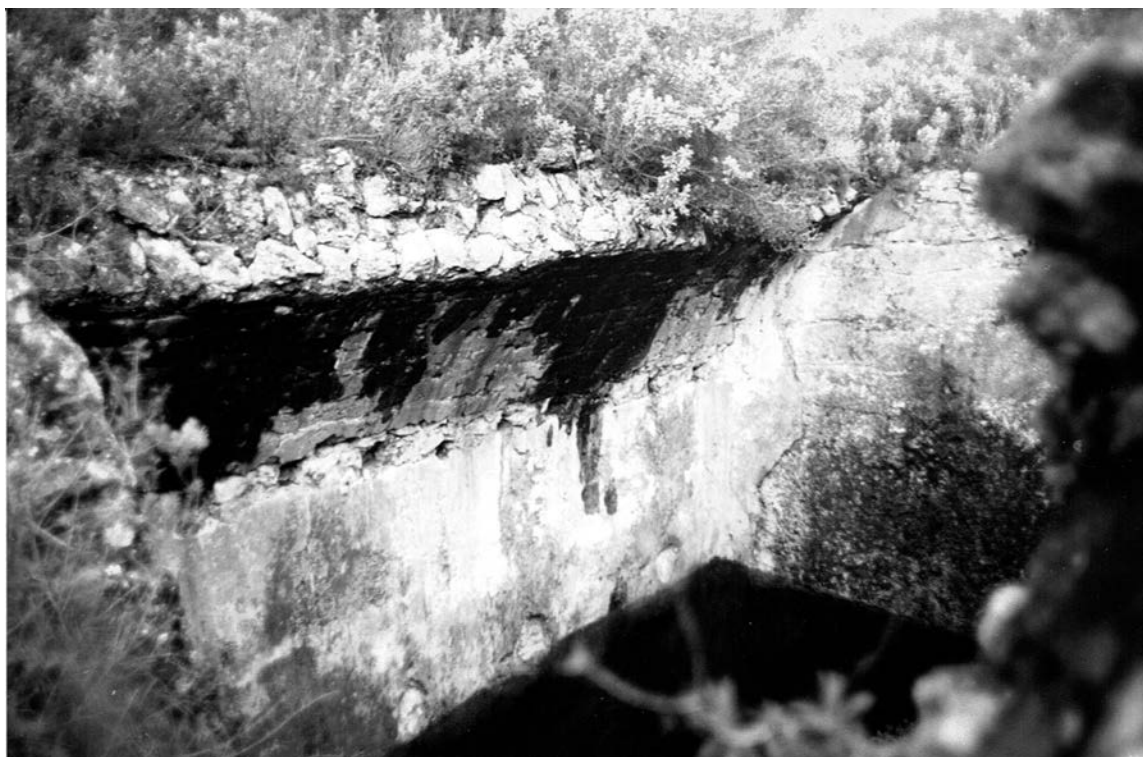
Fig. 6 – Vista parcial da cisterna fotografada em 1996 (Foto ICFF). Observe-se o revestimento de coloração avermelhada, destinado a assegurar a boa qualidade da água, combatendo a eutrofização e a estanquicidade da cisterna.
