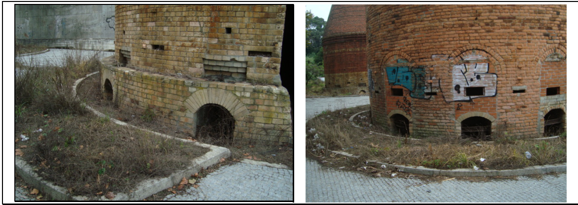
Fig.83 - Fornos “garrafa” de Quebrantões do Norte com sinais evidentes de vandalismo e o espaço envolvente marcado pelo abandono.
