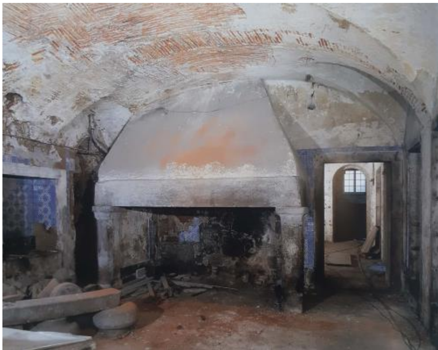
Figura 4.9. - Degradação do interior da casa, nomeadamente na pintura das paredes de uma das salas (Alves & Piqueiro, 2003).
