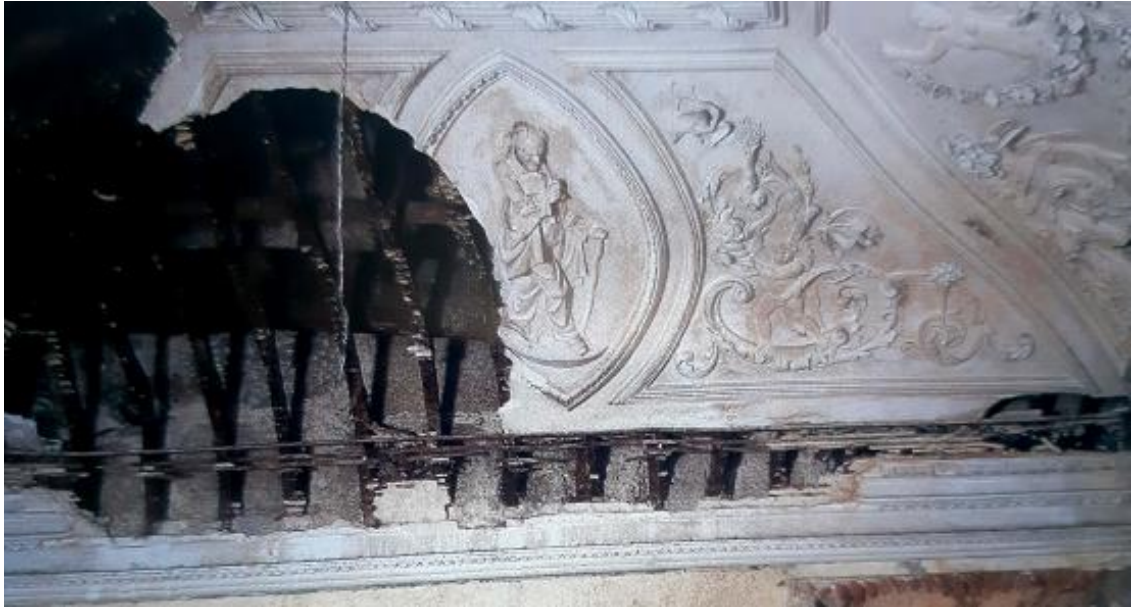
Figura 4.11. - Pormenor da degradação da decoração em estuque do teto - Sala do Visconde Velado (Alves & Piqueiro, 2003).
