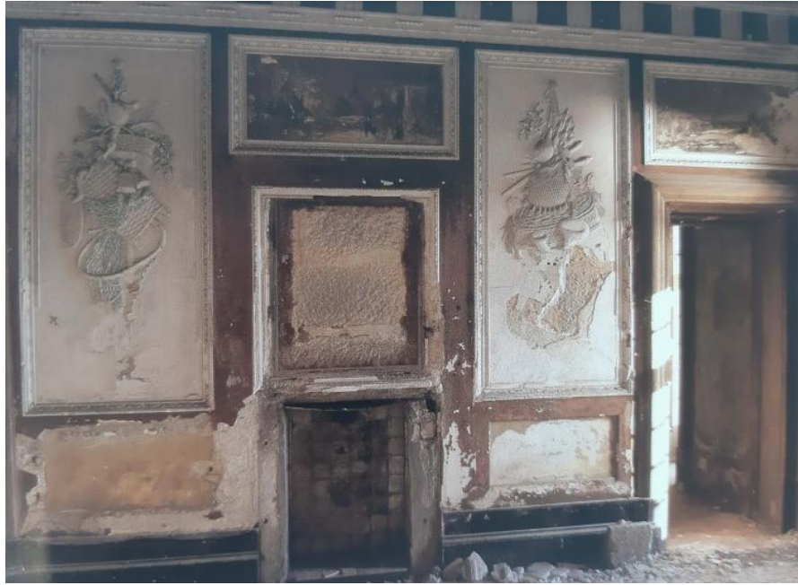
Figura 4.8. - Degradação do interior da casa, nomeadamente ao nível da pintura e da decoração em estuque - Sala do Visconde Velado (Alves & Piqueiro, 2003).
