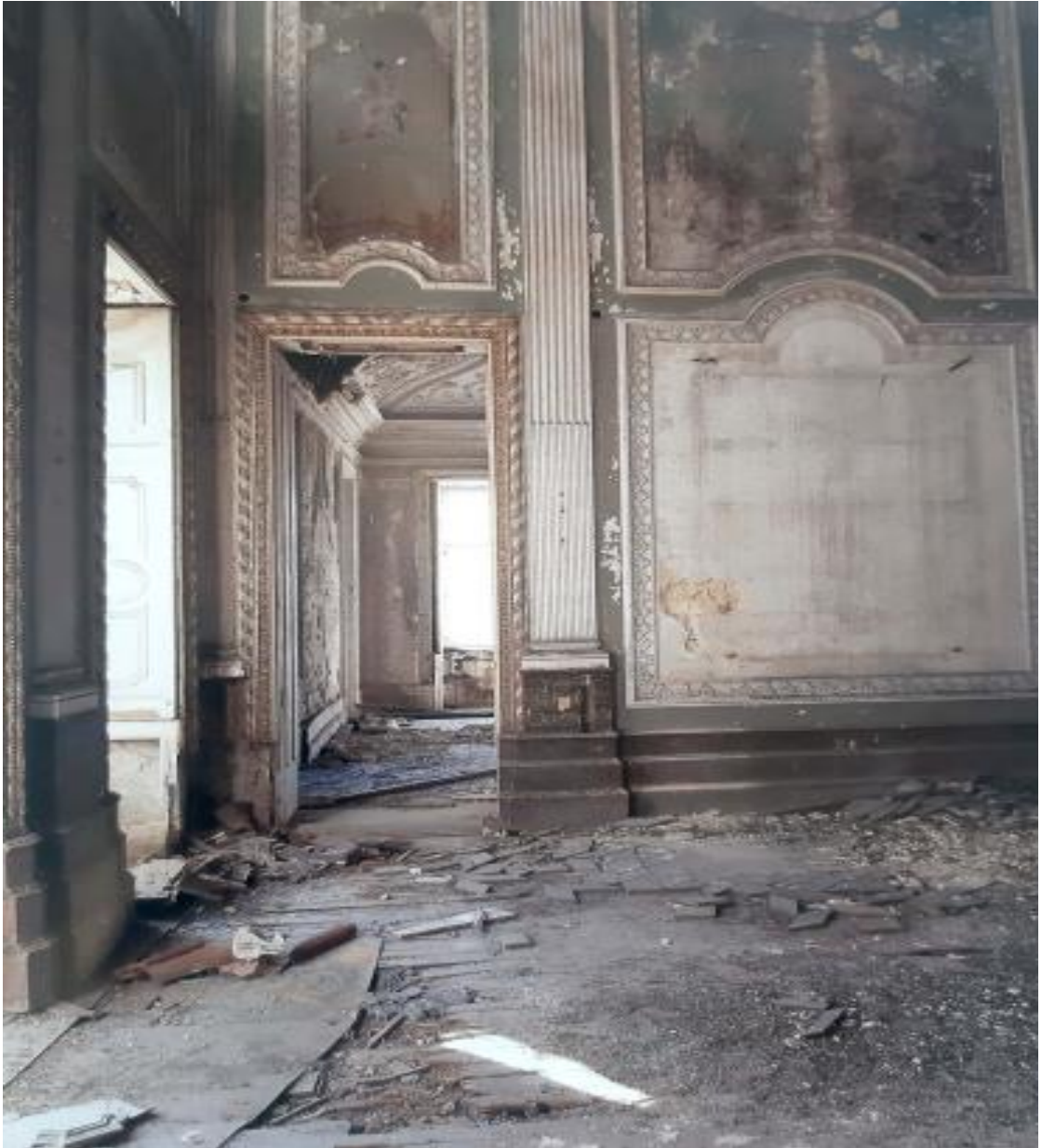
Figura 4.13. - Degradação do interior da casa, nomeadamente ao nível do chão e das paredes - Sala dos Espelhos (Alves & Piqueiro, 2003).
