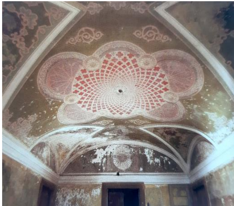
Figura 4.15. - A degradação do interior da casa, nomeadamente ao nível da pintura dos tetos do Hall (Alves & Piqueiro, 2003).
