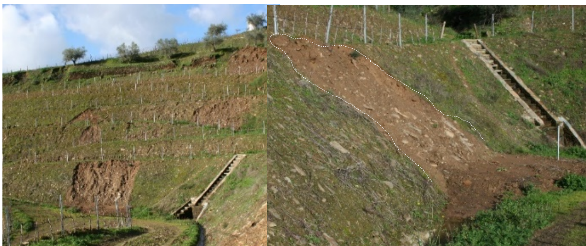
Figura 2. Exemplos de deslizamentos superficiais translacionais ocorridos em janeiro de 2023.
