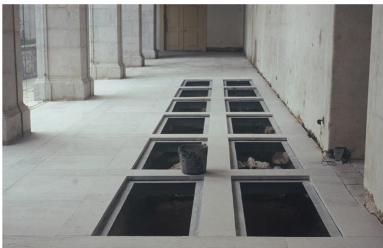
Fig. 3 – Vista da recuperação museológica, em curso a 30 de Novembro de 2005, da intervenção arqueológica em fase de conclusão, correspondendo à substituição do pavimento de lajes aparelhadas de calcário por estrutura em ferro destinada à colocação de painéis de vidro resistente, por forma a permitirem a visualização da escavação (Foto de J. L. Cardoso).
