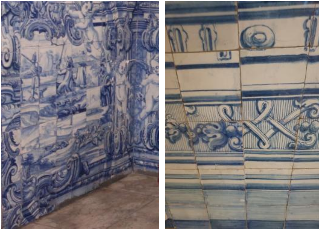
Figura 39 - Azulejos mal colocados, entrada do Seminário Patriarcal - Foto obtida por José João Gomes 2020-07-09
