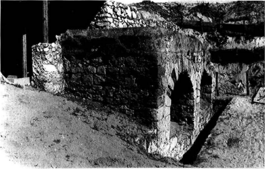
FOTO 3 – Instalação hidráulica de Tróia. Vista geral, notando-se o poço e o revestimento exterior do tanque
