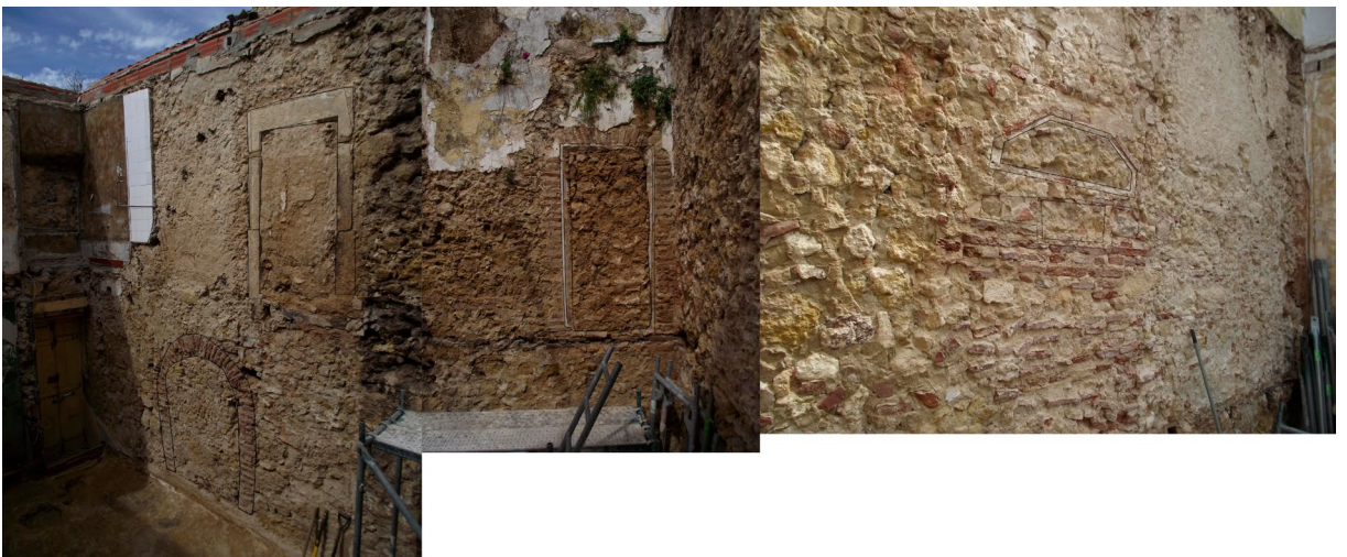
Fig. 8: Aspectos gerais dos elementos arquitetónicos identificados (elementos parietais na parede nordeste; portal com ombreiras e lintel em alvenaria de tijolo no piso superior da parede nordeste; armário de parede no piso superior da parede sudeste).
