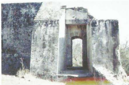
Figura 19.35 Barragem das Silveiras. Vista de jusante, notando-se a descarga de meio fundo e a brecha da barragem (à direita).
