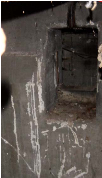
Figura 64 – Pequeno nicho existente na cave da zona “B”, que pode corresponder ao túnel exibido na Fig.57.
