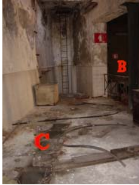
Figuras 62 e 63 – Estado actual da parede entre “B” e “C”.
