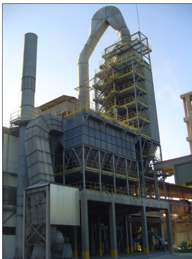
Figura 4.4.1.2. Fotografia Parcial do Filtro de Mangas da Indústria em Estudo. Fonte: Cimenteira Estudada, 2014.
