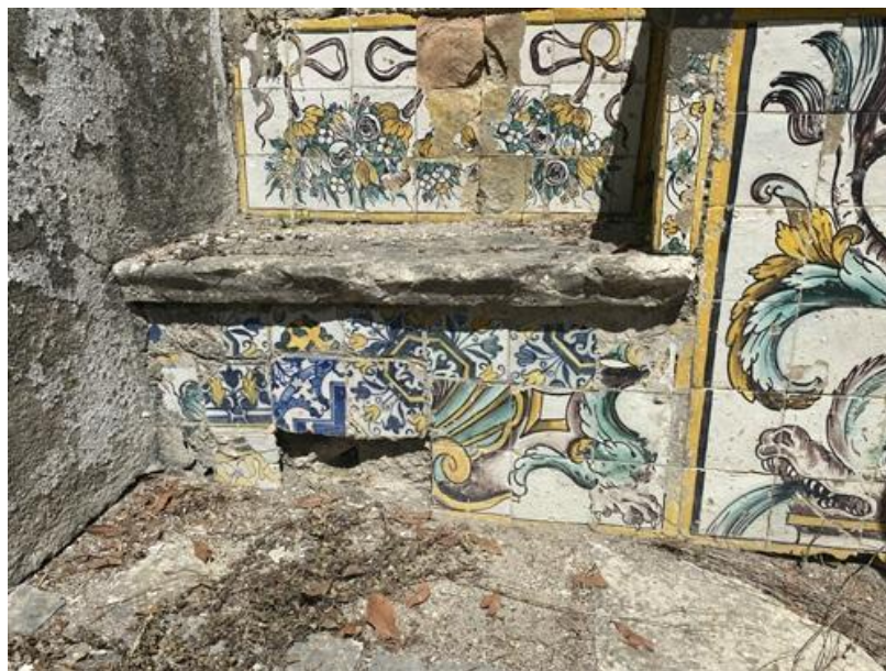
Fig. 146 – Painéis de azulejos da secção 1, níveis 1 e com lacunas e azulejos que não pertencem.
