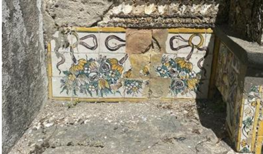
Fig. 150 – Secção 1, nível 2 com azulejos policromos com argolas, laçaria e ramos floridos, em mau estado de conservação.
