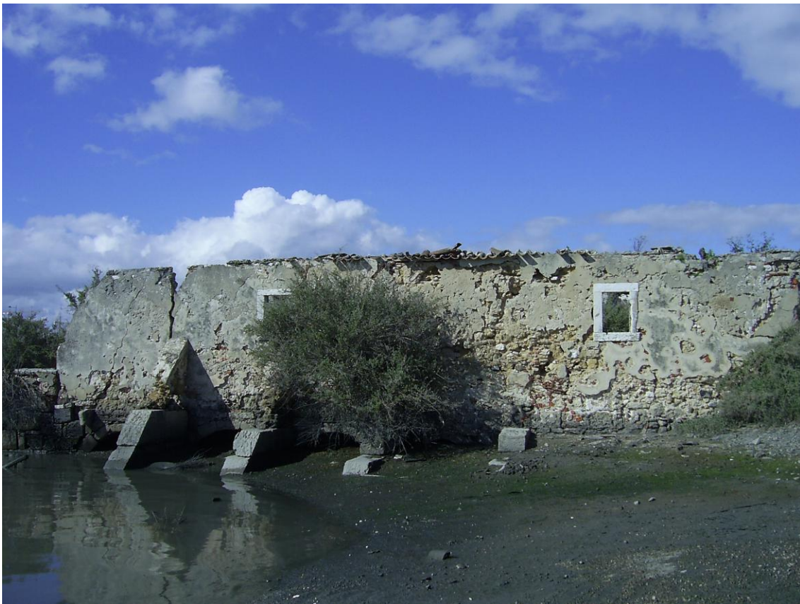
Fig.2 – Moinho de Maré da Lançada em ruínas. Crédito fotográfico: Liliana Campeão dos Santos.
