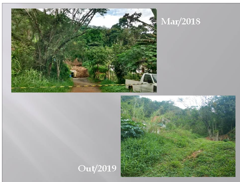
Figura 3.7 - Área do desmoronamento. Mar/2018 e Out/2019
