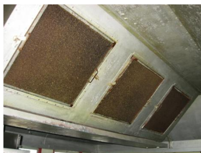
Figura 28: Os filtros do sistema de exaustão estão em mau estado de conservação e higiene.
