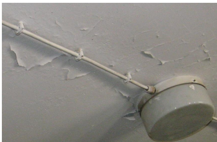
Figura 22: Estado de conservação do tecto do armazém
