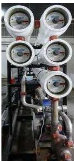
Figura 7 – Osmose inversa (1º estágio)
