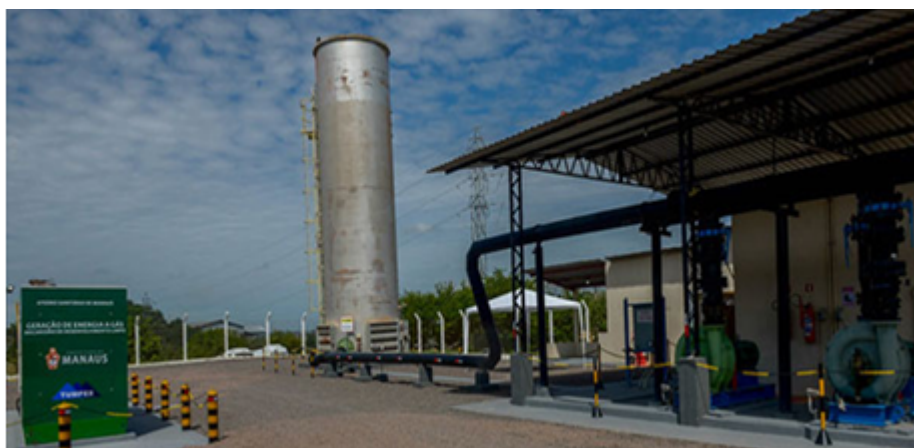
Figura 5.21: Instalações para queima do biogás e geração de energia elétrica
