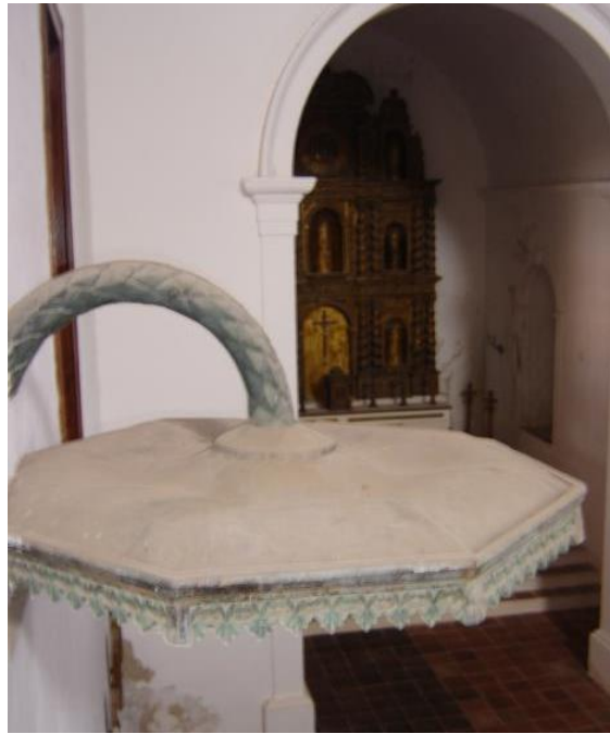
Fig. 2.24- Sobrecéu do púlpito da Igreja de S. Paulo, onde se observa o seu suporte escamado, semelhante à cauda de um dragão. Fotografia da autora. Abril de 2007.
