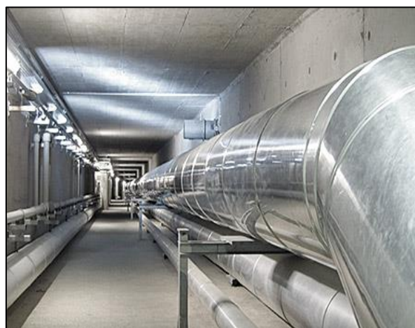
Fig. 5.19: Conduitas de FEWAG (Buschs, 2018)
