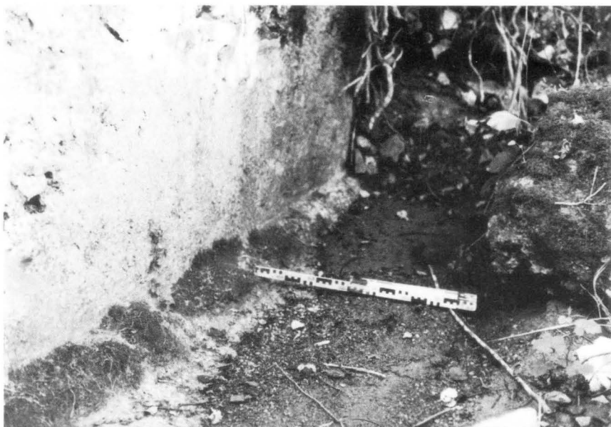
Fot. 12 — Barragem do Muro (Campo Maior) . Revestimento argamassado ligado à base do muro, a montante (talvez sapata de fundação), na zona da possível descarga de fundo.
