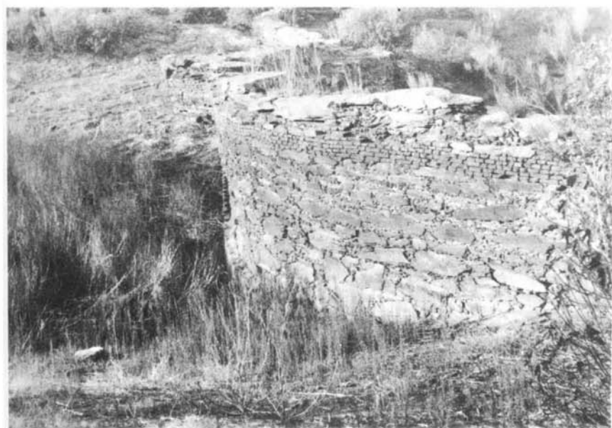
Fot. 74 — Barragem de Monte Novo (Évora). Paramento de montante, observando-se as fiadas de tijolo para regularização do coroamento (fotografia da DGRAH).
