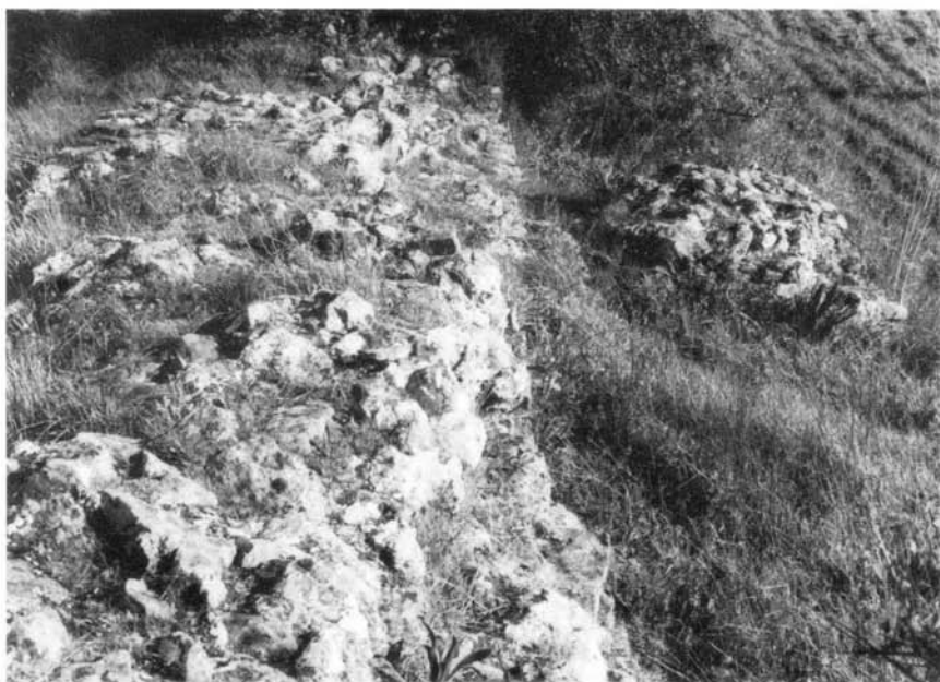
Fot. 28 — Barragem de Nossa Senhora da Represa (Cuba). Pormenor construtivo do núcleo, de opus incertum. Observa-se também um dos contrafortes.
