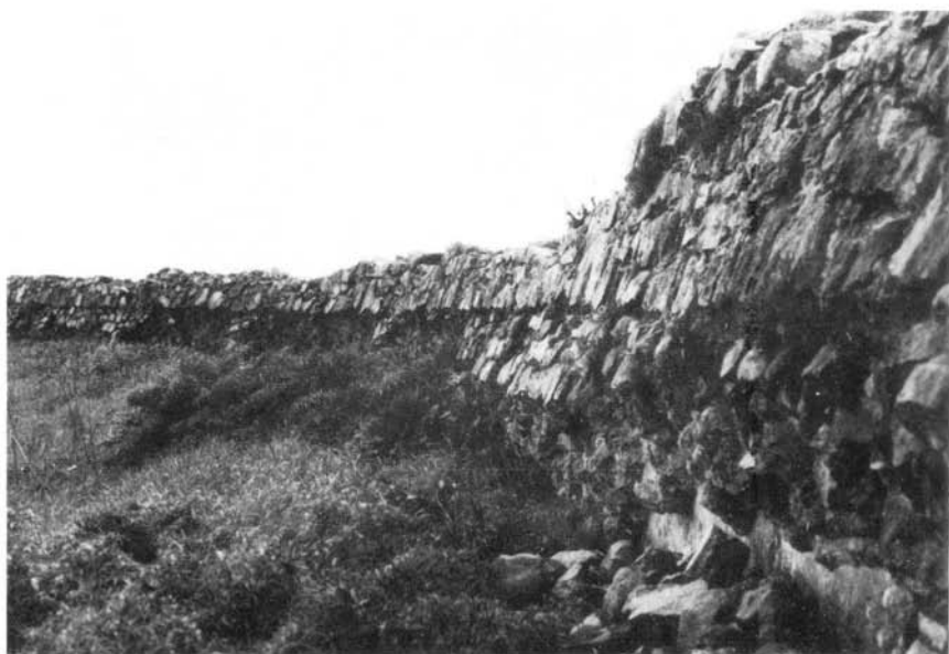
Fot. 50 — Barragem do Muro dos Mouros (Serpa). Paramento de montante. Observe-se a inclinação do muro e o avanço da última fiada de blocos (ver Fot. 48).
