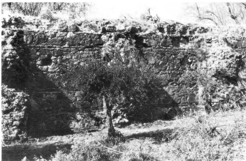
Fot. 11 — Barragem do Muro (Campo Maior) . Paramento de jusante, sendo visíveis três dos contrafortes.
