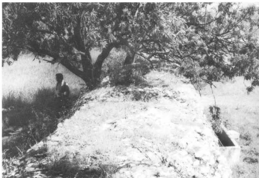
Fot. 64 — Barragem da Fonte Coberta (Lagos). Vista do coroamento. Evidencia-se o acentuado assoreamento da antiga albufeira, à esquerda.
