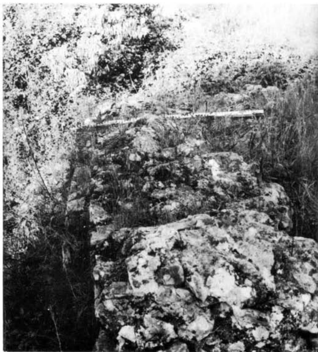
Fot. 4 — Barragem de Almarjão (Portalegre). Pormenor da estrutura, notando-se dois degraus, no paramento de jusante.
