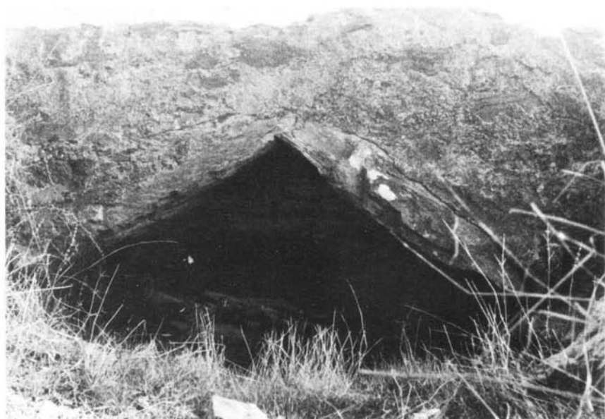
Fot. 75 — Barragem de Monte Novo (Évora). Aspecto duma das aberturas a jusante para possível descarga de fundo (fotografia da DGRAH).
