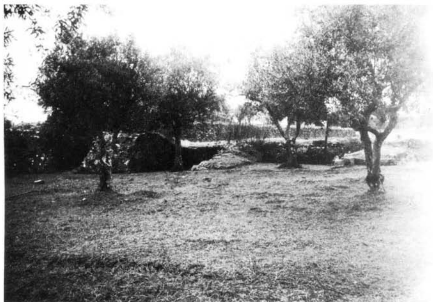
Fot. 105 — Tanque dos Mouros (Estremoz). Vista da zona externa do muro sul-oriental, suportado por contrafortes.
