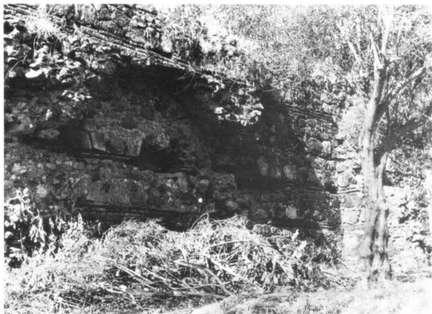
Fot. 9 — Barragem do Muro (Campo Maior). Paramento de jusante, notando-se um dos três arcos existentes no troço central.
