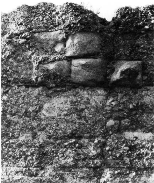
Fot. 19 — Barragem de Moralves (Elvas). Pormenor do paramento de jusante, vendo-se restos dos blocos graníticos do revestimento (opus quadratum), muito arenizados.
