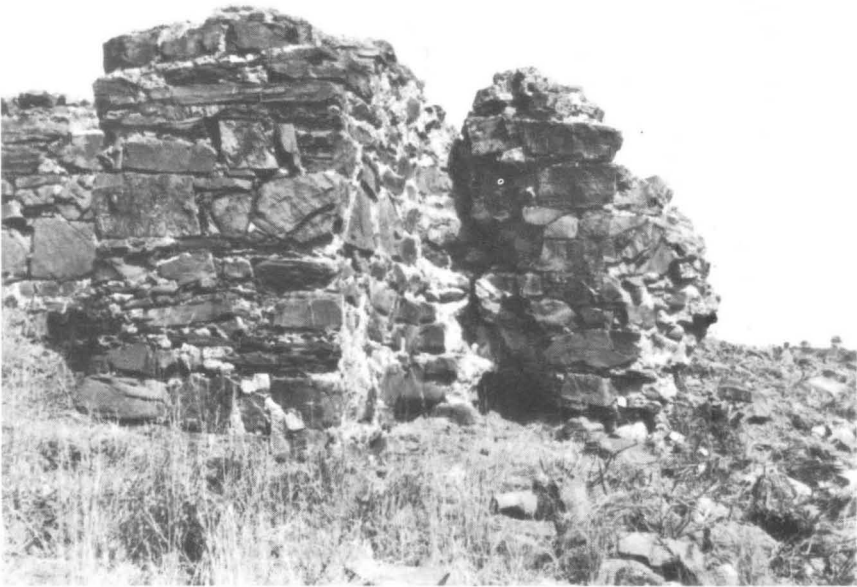
Fot. 58 — Barragem de Santa Rita (Vila Real de Santo António). Pormenor de um dos contrafortes e de parte do muro derruído.
