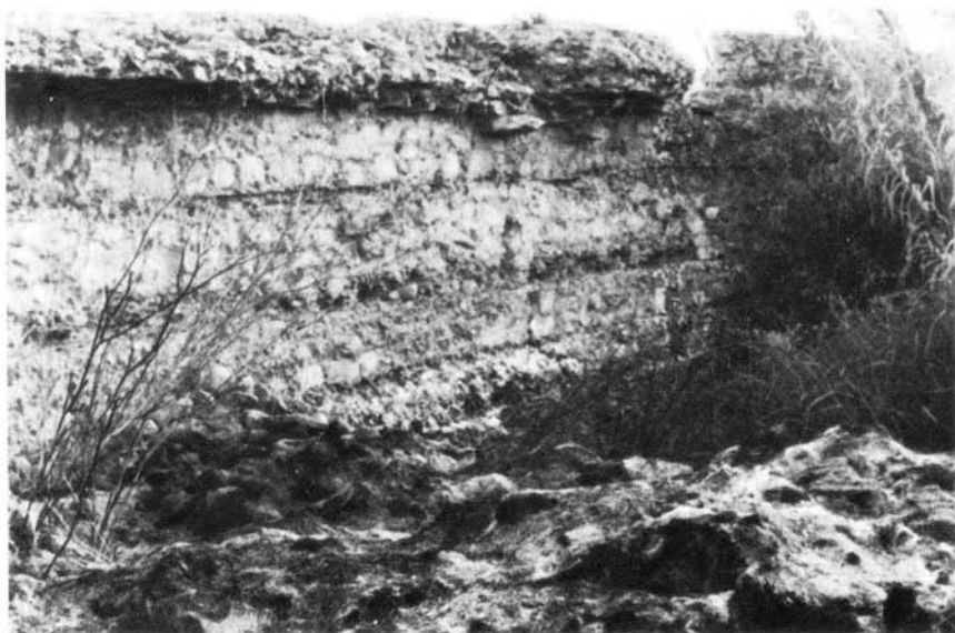
Fot. 20 — Barragem de Moralves (Elvas). Paramento de montante, vendo-se, ao nível do coroamento, restos de uma lage de betão, em consola, utilizada provavelmente como passadiço.
