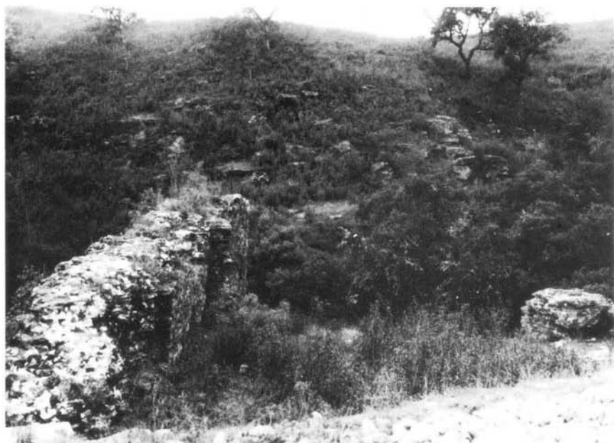
Fot. 69 — Barragem da Represa (Gavião). Aspecto dos dois muros, contraventados por septos transversais. O espaço interior é preenchido por aterro argiloso.
