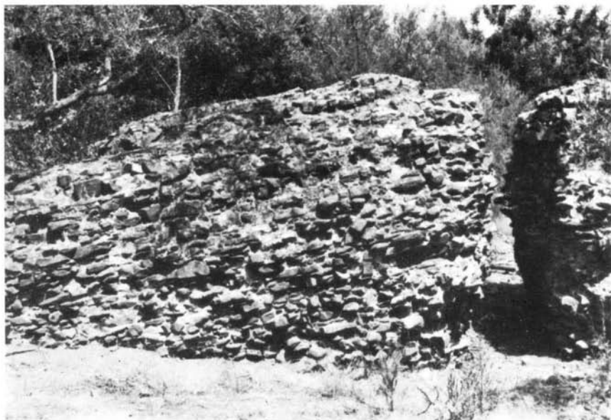
Fot. 55 — Barragem do Álamo (Alcoutim). Vista do paramento de montante, notando-se a brecha por onde corre a linha de água e um bloco que basculou.
