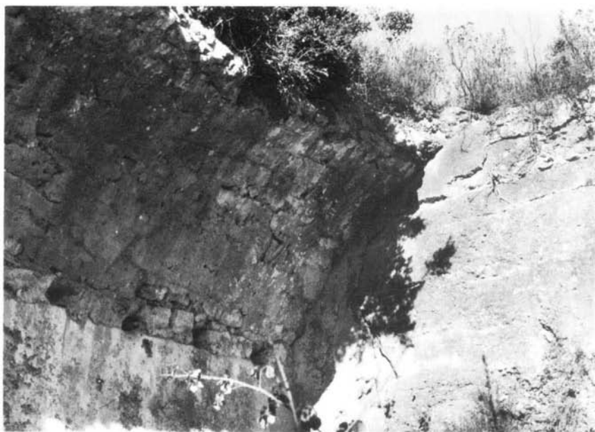
Fot. 109 — Cisterna do Casal do Bispo (Sesimbra). Pormenor do arranque da abóboda (provavelmente mais recente), observando-se a inserção do travessamento que suportava os simples (cujas impressões são ainda visíveis).
