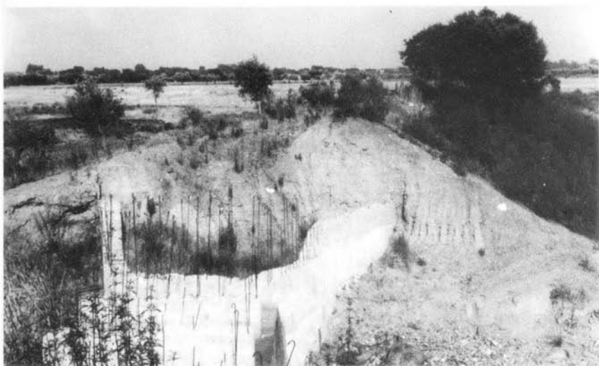
Fot. 85 — Barragem da Lameira (Vila Velha de Ródão). Vista do talude do aterro, na zona da ruptura da barragem, com construção recente.
