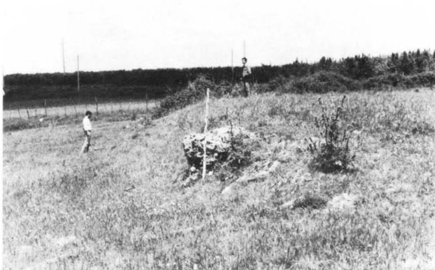
Fot. 23 — Barragem do Carrão (Elvas). Vista de montante da estrutura, muito destruída, marcada pelo desnível do terreno.
