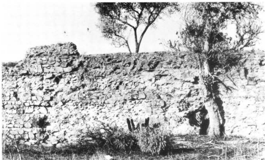
Fot. 41 — Barragem de Pisões (Beja) . Vista de jusante mostrando uma descarga de fundo, à direita, parcialmente encoberta pela árvore.
