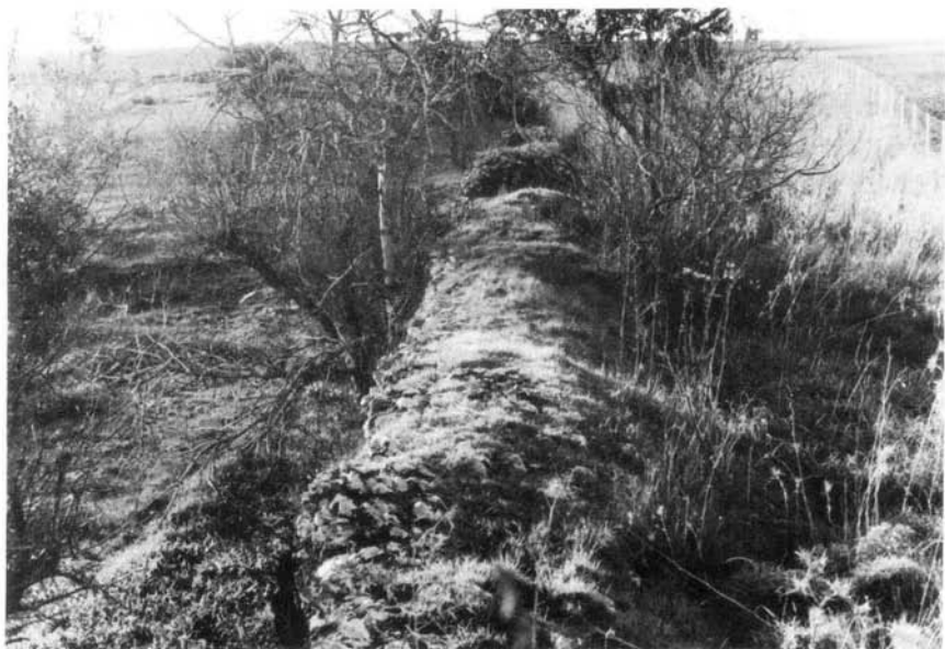
Fot. 44 — Barragem de Pisões (Beja). Aspecto de coroamento, notando-se o asso-reamento da antiga albufeira, à direita.
