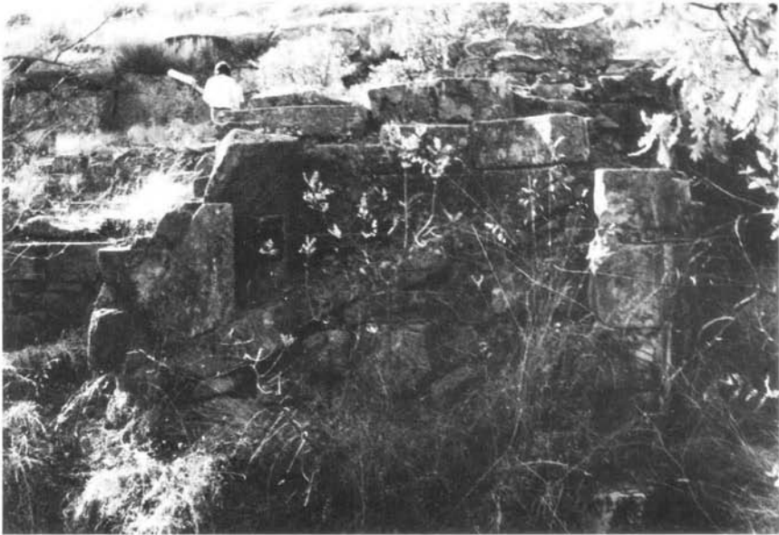
Fot. 77 — Barragem da Cabeça Pelada (Alcains). Vista obtida da margem esquerda, notando-se a zona de ruptura da barragem junto da linha de água e a entrada para o cubo de uma roda hidráulica.
