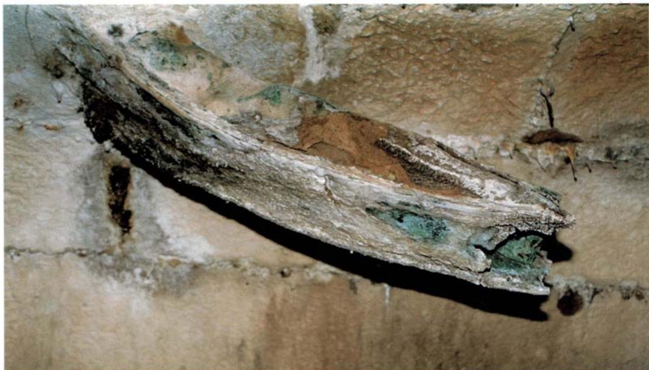
Fot. 20 - Conduta metálica que dirige o jacto para uma das azenhas da Fábrica de Baixo
