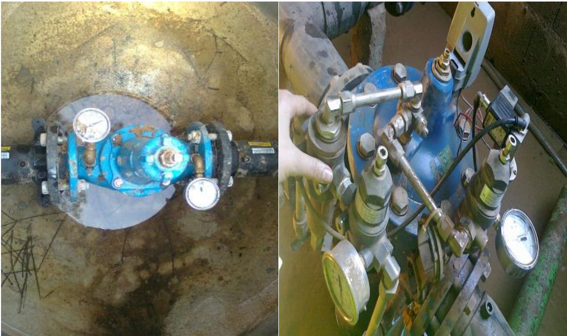
Figura 4.29 - Fotos de Válvulas Redutoras de Pressão (VRP)
