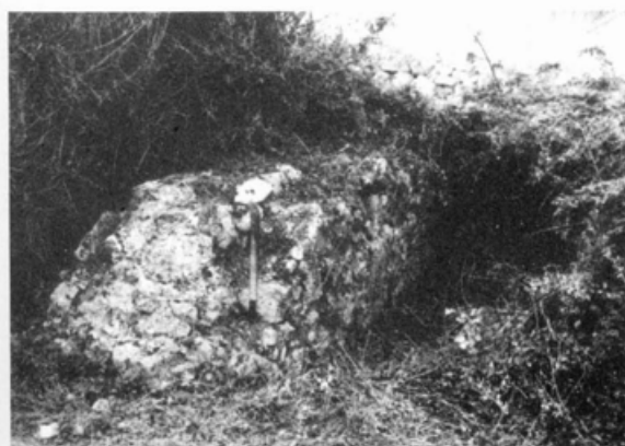
Fot. 14 - Barragem de Espiche. Vista do paramento de montante do troço existente (margem esquerda).
