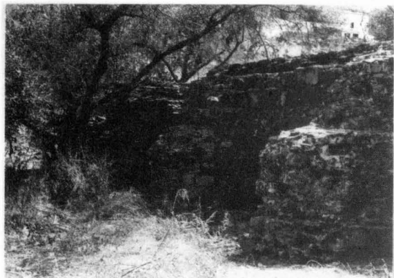
Fot. 1 - Barragam do Álamo. Vista de jusante, notando-se dois dos con- trafortes.
