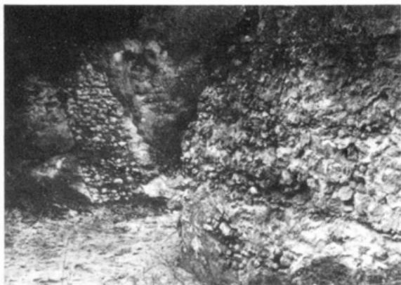
Fot. 12 - Barragem da Ponte dos Mouros. Vista do paramento de montante, notando-se o encontro esquerdo.
