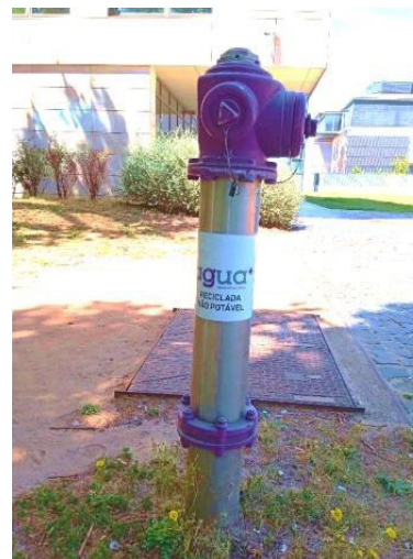
Figura 2. Ponto de abastecimento rede “água+, reciclada e não potável” (Lisboa) (Fonte: a autora)
