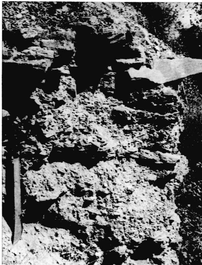
Photo 5 - Barrage d'Egitânia. Aspect de la structure du remblai de la brèche.
