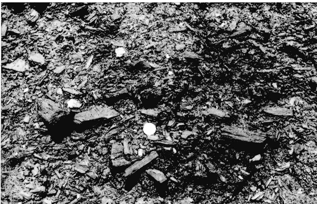
Photo 8 - Barrage de Lameira. Aspect de la structure du remblai au niveau de la brèche. Notez la pièce de 31 mm de diamètre.
