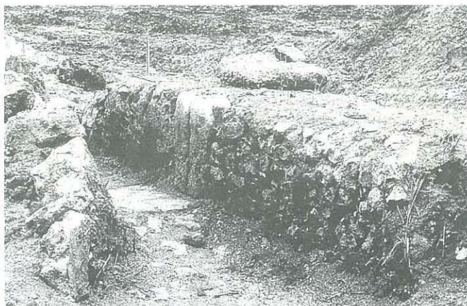
Barragem de Vale Tesnado (Loulé). Tomada de água para o aqueduto.
