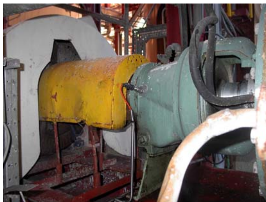
Fig. 5.82 – Aspecto do sensor de vibração montado numa bomba de pasta
