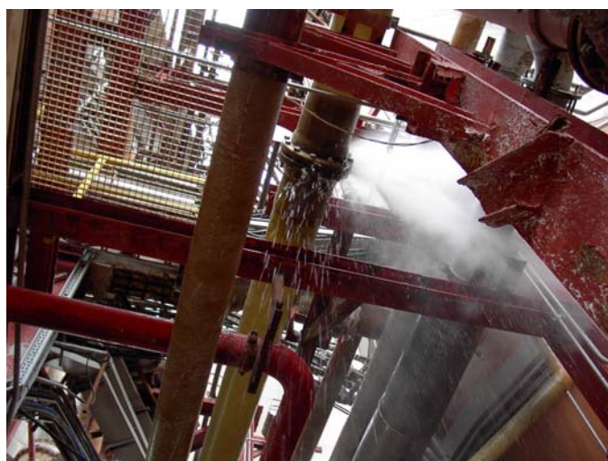
Fig. 5.1 – Fuga de fluido por falha de vedação
