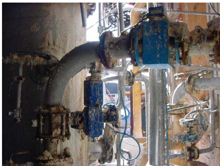
Fig. 5.5 - Equipamento (caudalímetro) de instrumentação em linha
