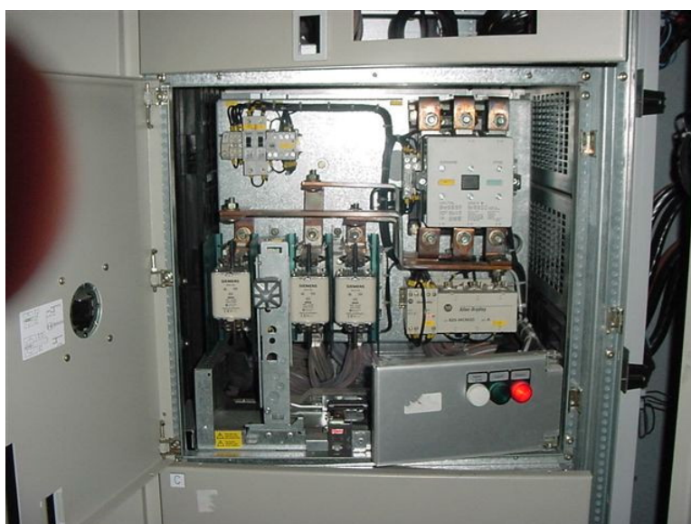
Fig. 5.8 – Cella (arrancador) de alimentação eléctrica
