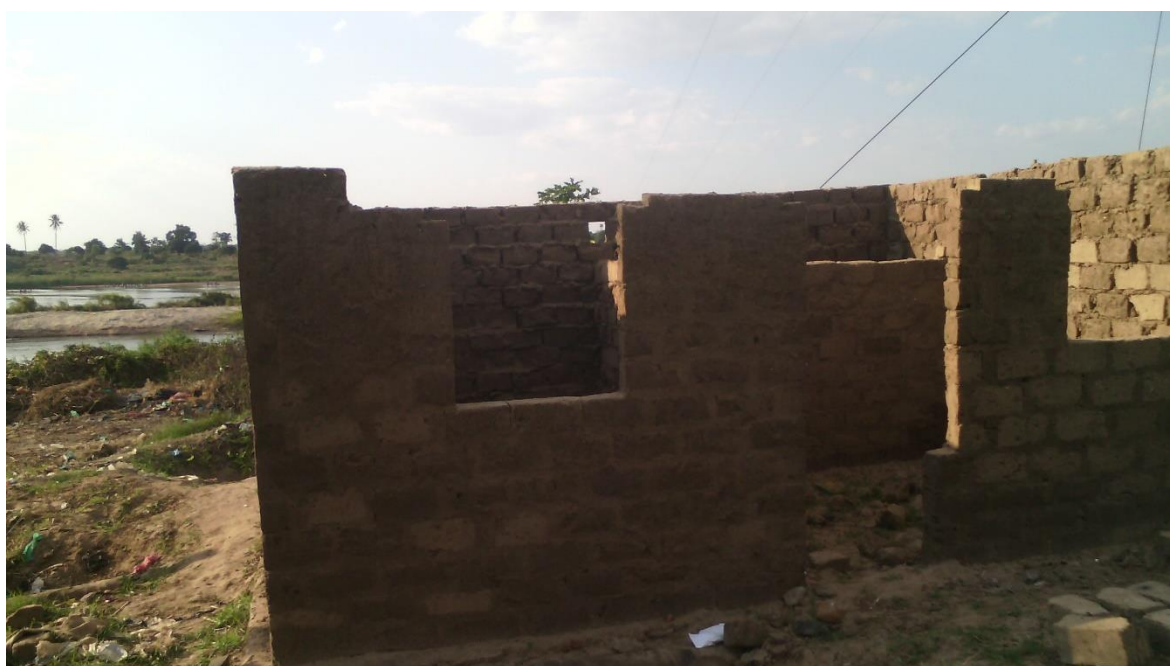
Uma casa em reconstrução no leito de cheias do bairro CFM em Mocuba – 2018
