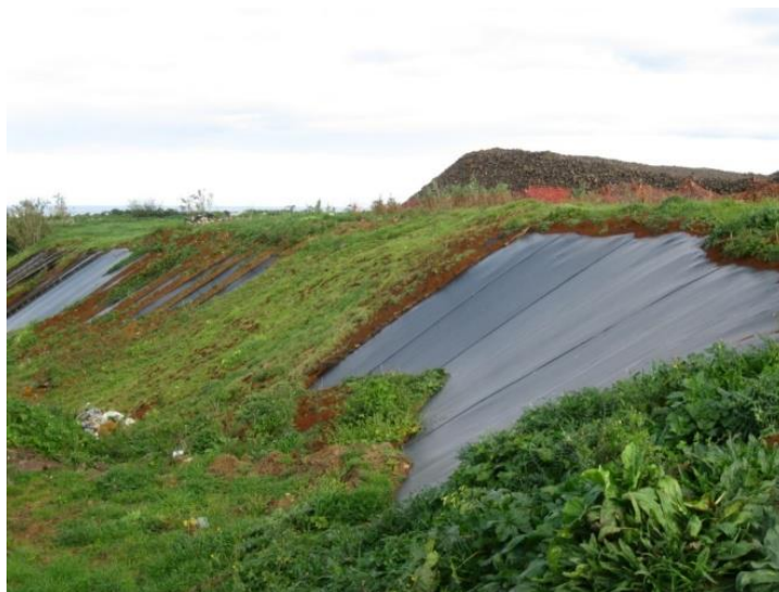
Figura 1.11. Danificação da célula impermeabilizada do Aterro Controlado de Santa Maria.
