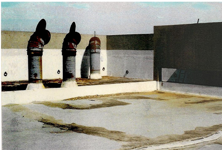
Foto 15 – Piso 6 (terraço), vista e bocas de ventilação com manga móvel e leme direccional, 1997 (fonte: Direcção Regional de Cultura de Lisboa e Vale do Tejo, processo de classificação DRL-92/3(2); foto nº 109, rolo 1; autor: arq. José Russo)
