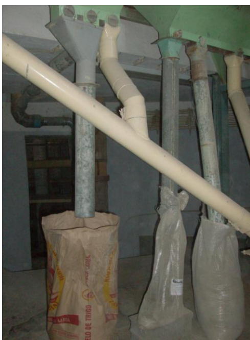
Foto 12 - Parte inferior do mecanismo de limpeza do cereal (trior), antes de ir para os moinhos; piso intermédio; nos sacos visíveis na foto está a "limpadura" (resultado da separação do trigo de outras sementes que o possam acompanhar); este produto secundário segue para alimentos dos animais, Agosto 2010 (Autora: Conceição Toscano)
