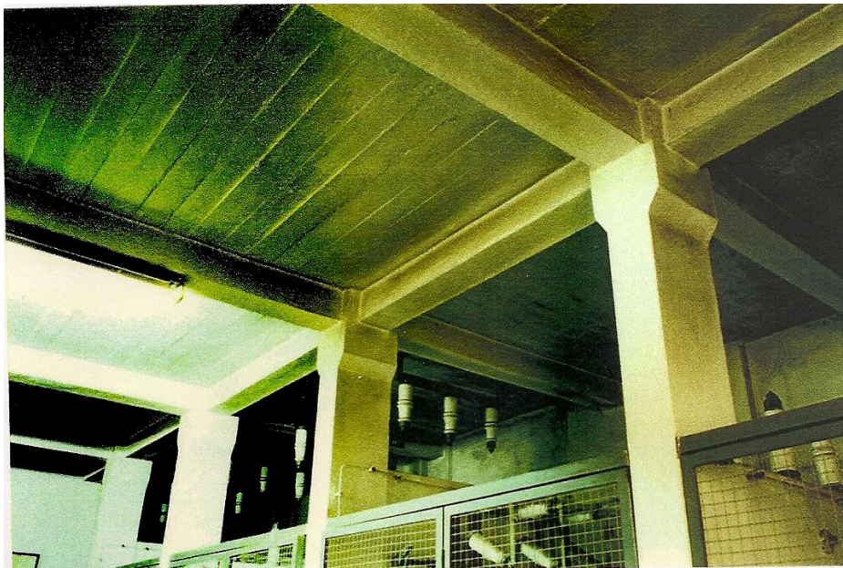
Foto 49 – Piso 0, ala sul, posto de alta tensão, 1997 (fonte: Direcção Regional de Cultura de Lisboa e Vale do Tejo, processo de classificação DRL-92/3(2); foto nº 309, rolo 3; autor: arq. José Russo)
