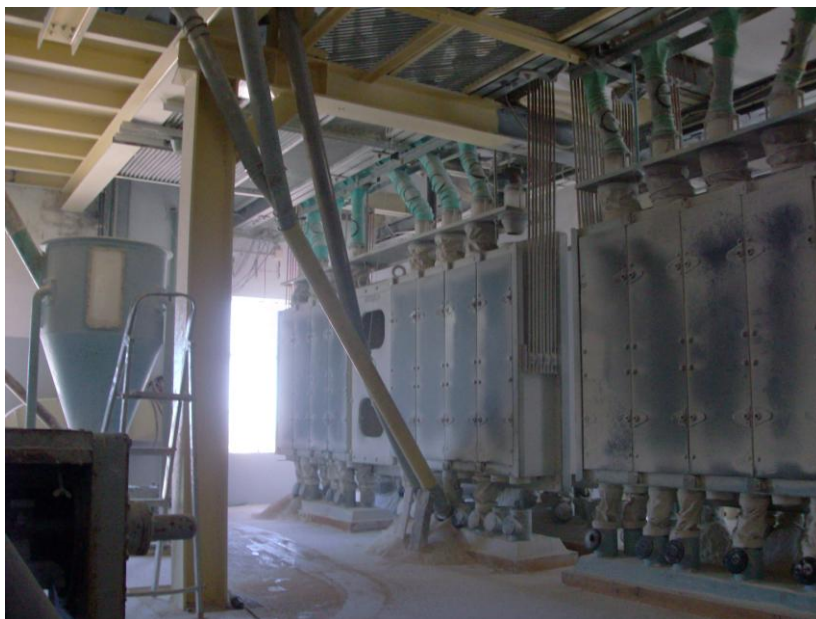
Foto 13 – Duas plansichters (adquiridas à Sociedade Industrial Aliança) situadas no 2º piso; as plansichters peneiram a farinha a partir do processamento dos moinhos de cilindros, situados no piso inferior, Agosto 2010 (Autora: Conceição Toscano)
