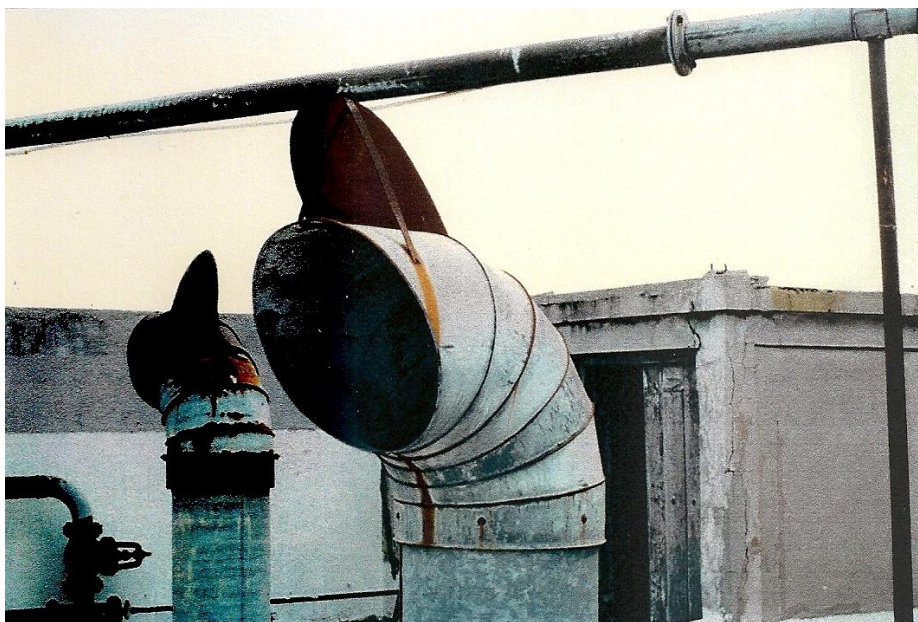
Foto 14 – Piso 6 (terraço), boca de ventilação com manga móvel e leme direccional, 1997 (fonte: Direcção Regional de Cultura de Lisboa e Vale do Tejo, processo de classificação DRL-92/3(2); foto nº 108, rolo 1; autor: arq. José Russo)
