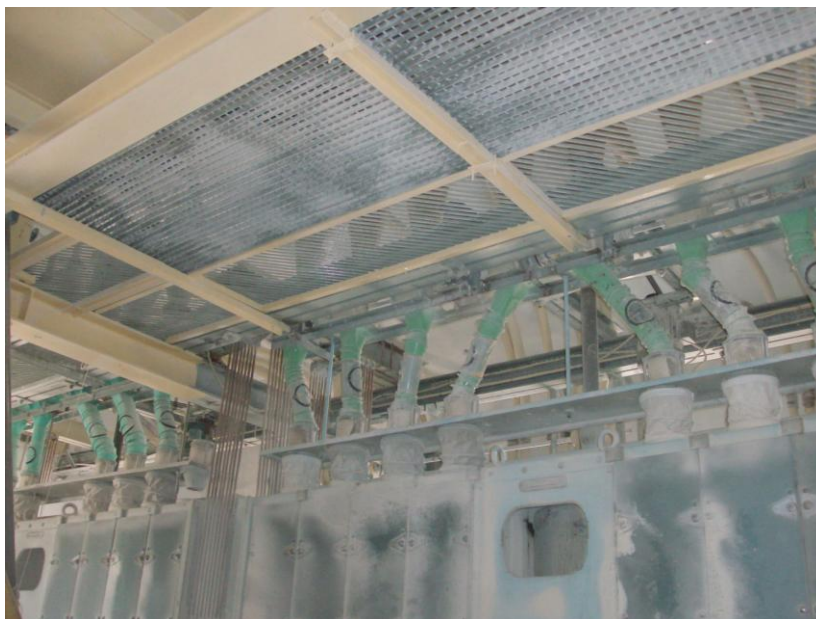
Foto 15 – Pormenor das tubagens situadas na parte superior das plansichters, Agosto 2010 (Autora: Conceição Toscano)
