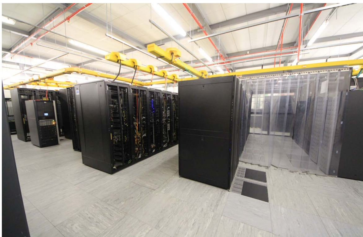
Figura 4.8 – Aspeto geral das infraestruturas de hardware ao serviço da INCD.
