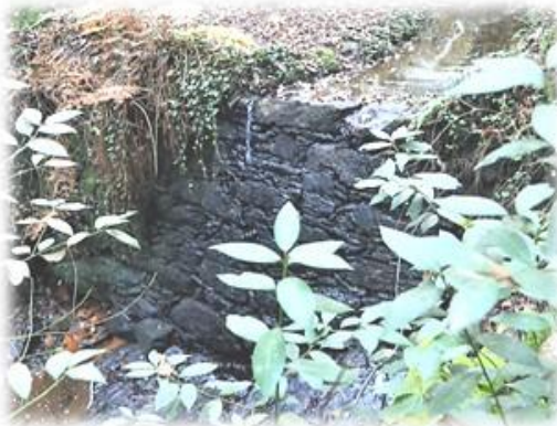
Fig. 18 Um muro antigo perpendicular à corrente de água situado alguns metros antes do moinho funcionando como uma represa.
